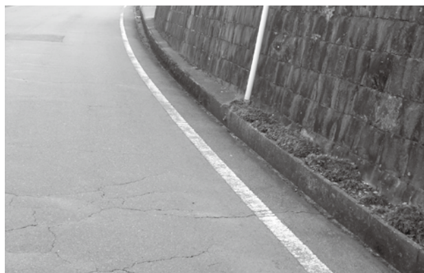
側溝に蓋のない小坂小の通学路
