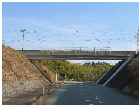
第3者被害対象(北園橋)
