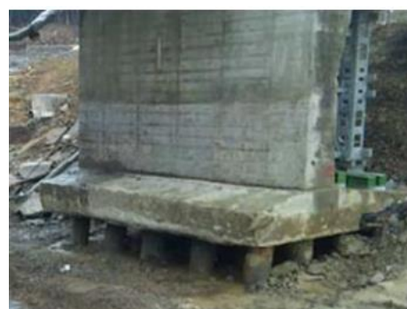
橋梁の洗堀状況(町外の橋梁)
