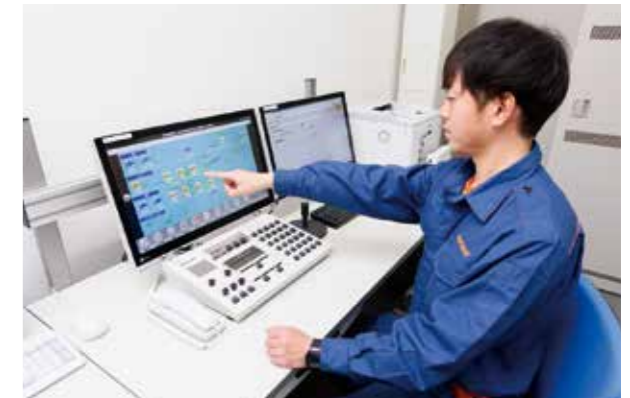
防災無線室・操作卓
