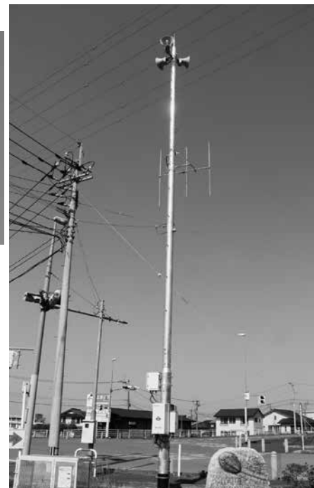
▲南木倉に設置しているスピーカー
