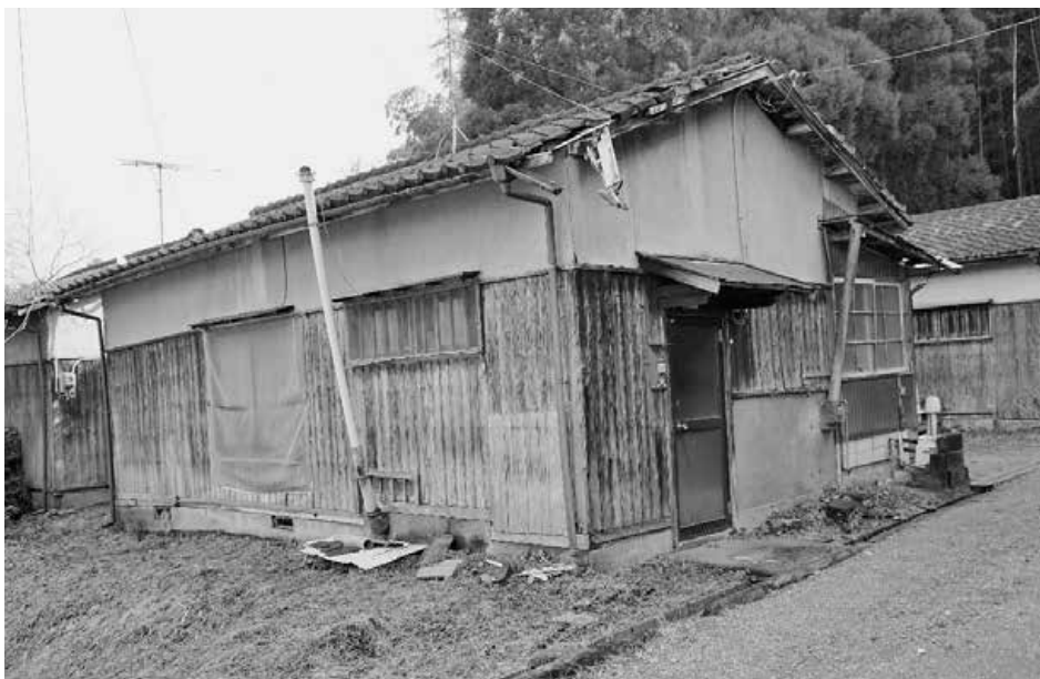
老朽化した町営住宅
