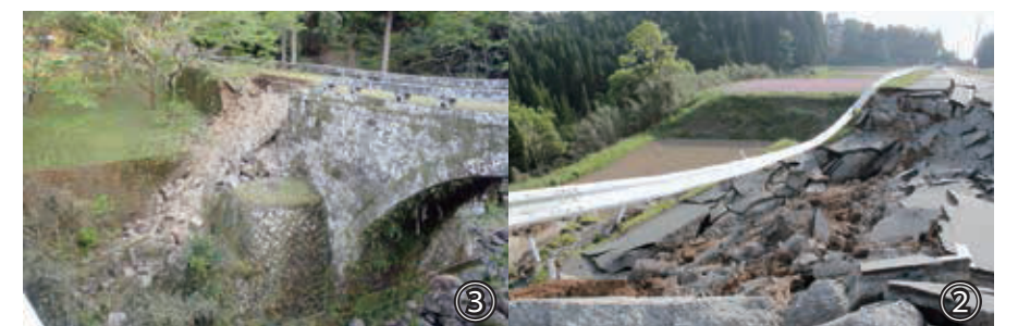
①_地震後に発生した国道445号の大規模な土砂崩れ（下鶴地区） ②_崩落した県道田代御船線（餅畑地区） ③_一部が崩れた県重要文化財の「八勢目鑑橋」（八勢地区）
