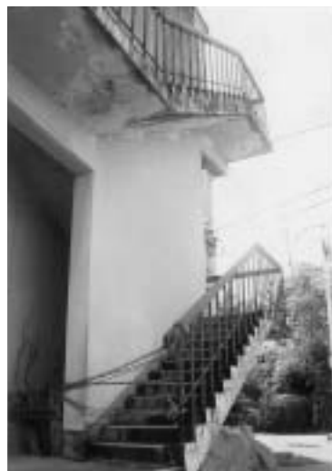
昇降禁止の非常階段 (御船小学校)
