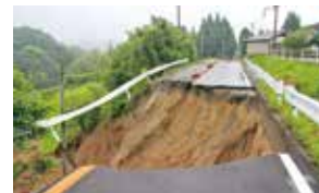
▲豪雨によって流された国道445号
